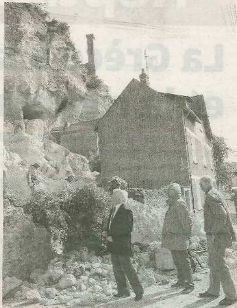
Les nouvelles expertises réalisées hier ont abouti à un constat alarmiste : des risques d'éboulement subsistent.
